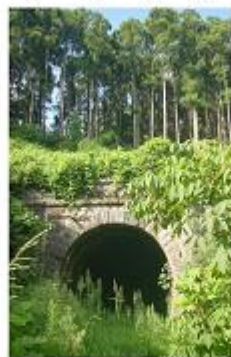
入口を夏草におおわれた明治のトンネル。現在は、すぐ右側にあるトンネルが、上り線専用に使われています。
